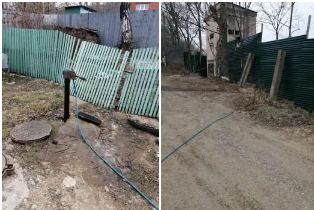
Рис. 13. Незаконное подключение к водораспределительной колонке строителями «Армады»
